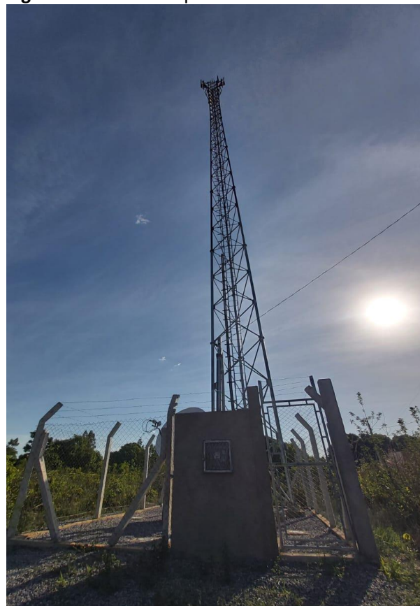
Figura 72. Torre da Operadora TIM.
